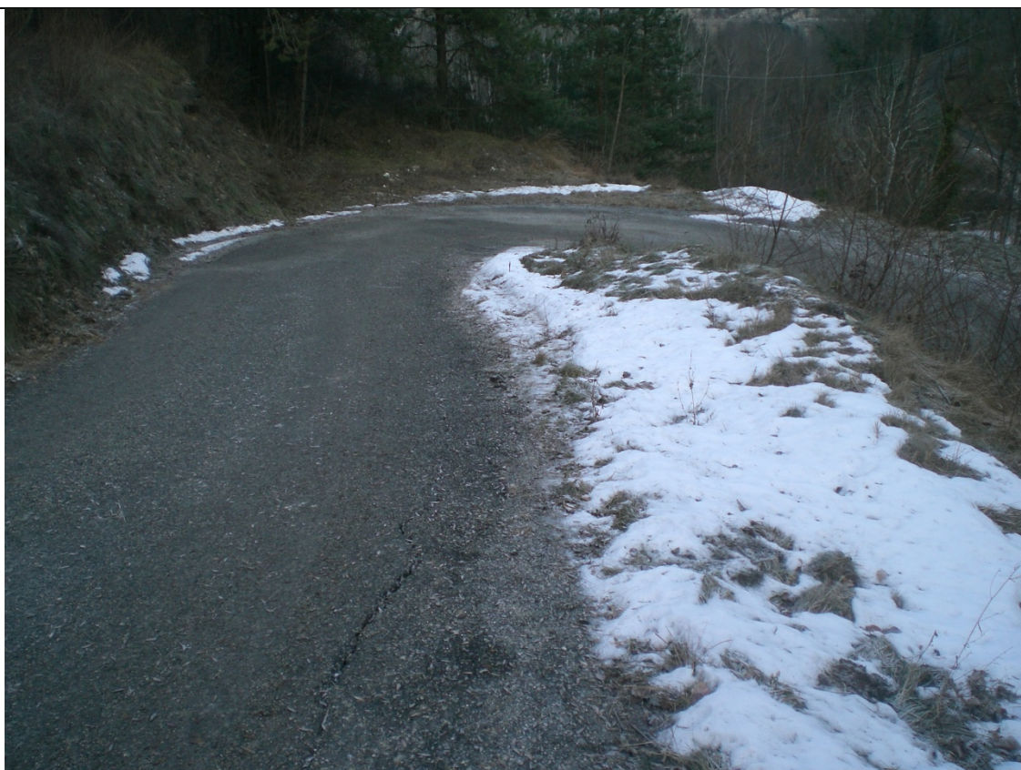
Figura 3 - Intervento 2 - Vista da monte del primo tornante
