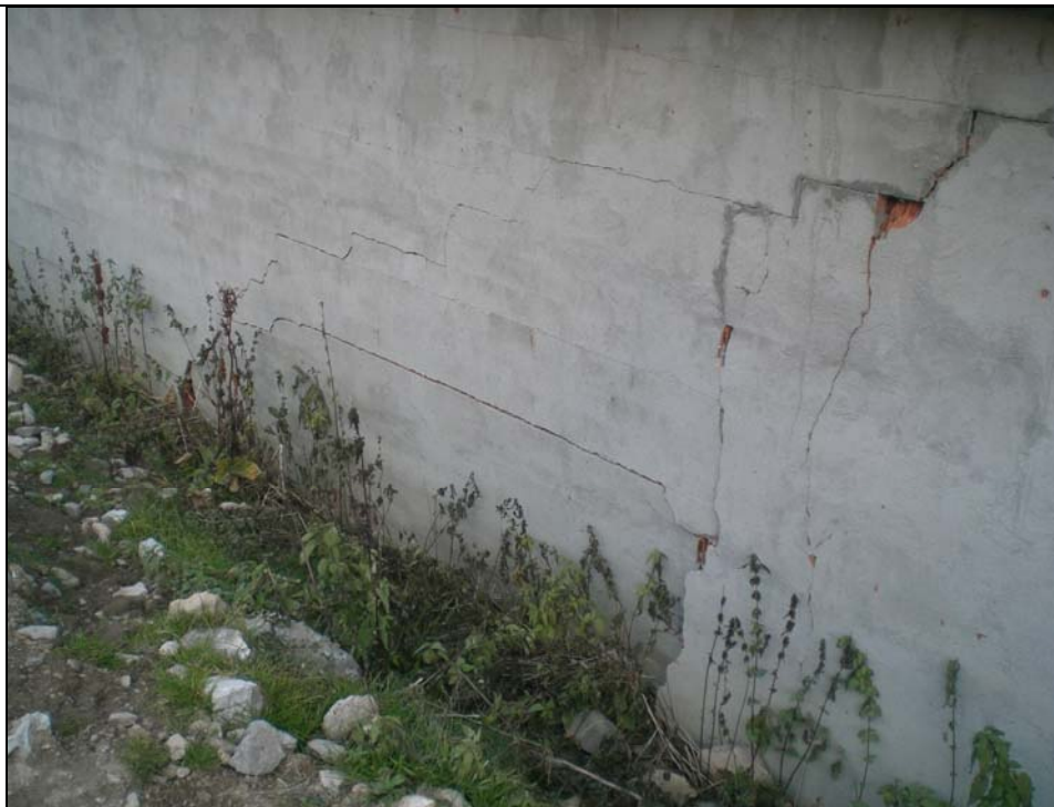
Foto n. 1: STALLA DEL BESTIAME – Vista del muro posteriore danneggiato a causa della spinta del terreno retrostante.
