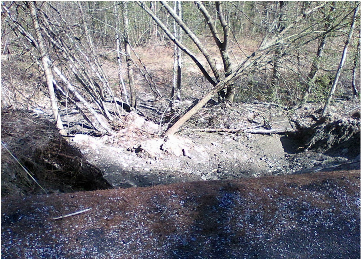
Foto 2 - Vista della "frana di monte" e del sottostante accumulo.
