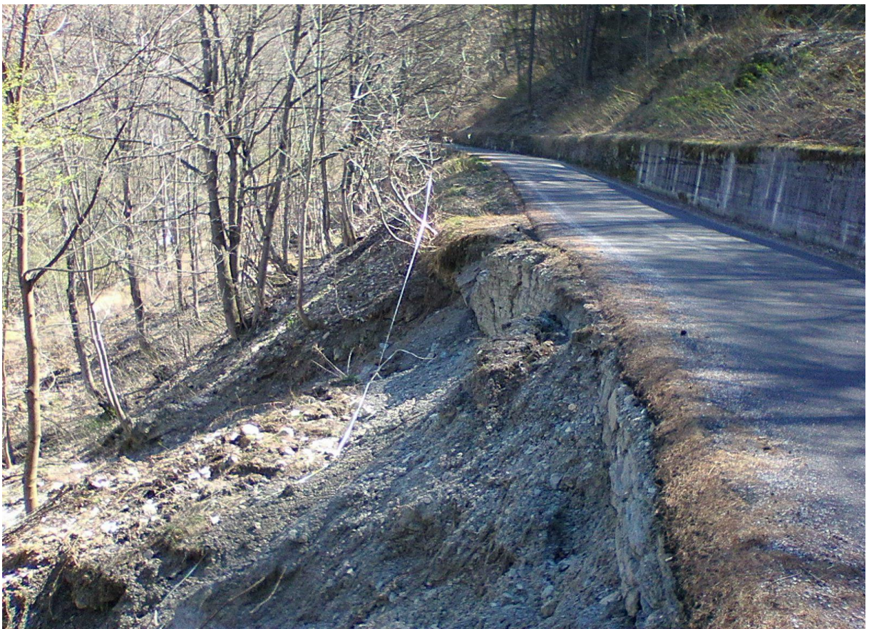
Foto 1 - Vista da monte della "frana di monte" e del muro di sottoscarpa gravemente danneggiato.
