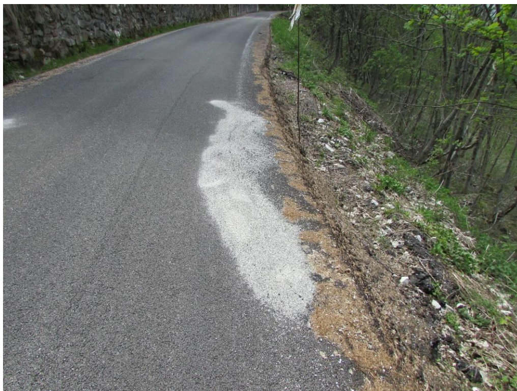
VISTA DI DETTAGLIO DELLA FRANA A VALLE
