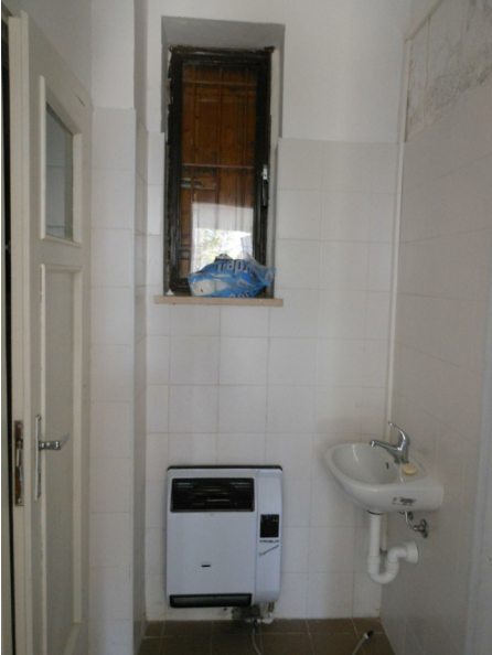
1. Corpo scaldante a gas - Piano terreno
