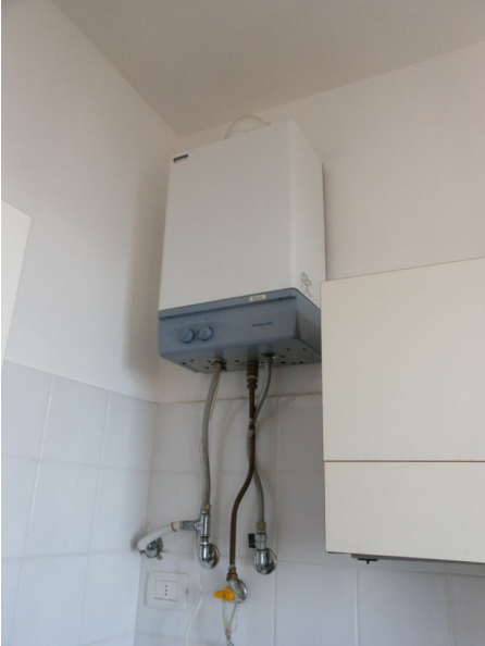
2. Scalda acqua a gas - Piano primo
