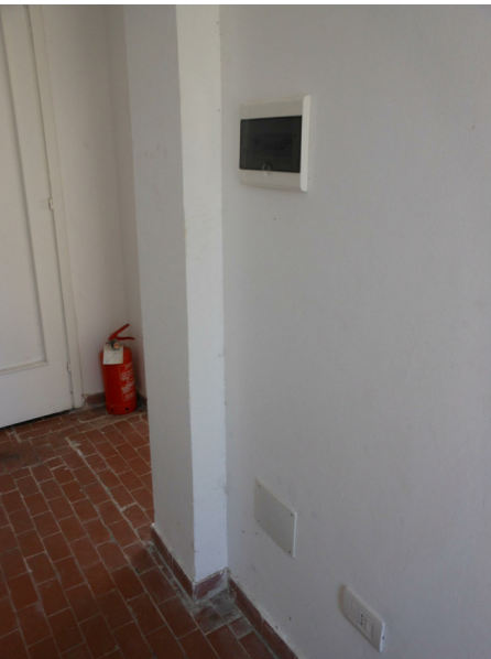
4. Quadro elettrico generale - Piano terreno
