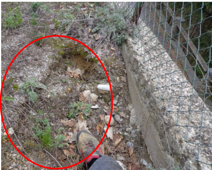
Particolare cedimenti del terreno a monte sul campo da bocce
