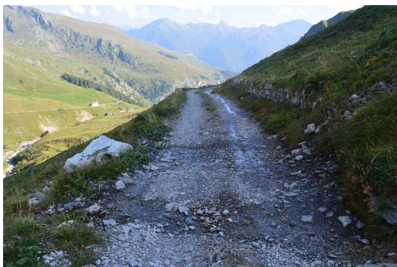
Fig. 11 Tratto interessato da infiltrazioni di acqua
