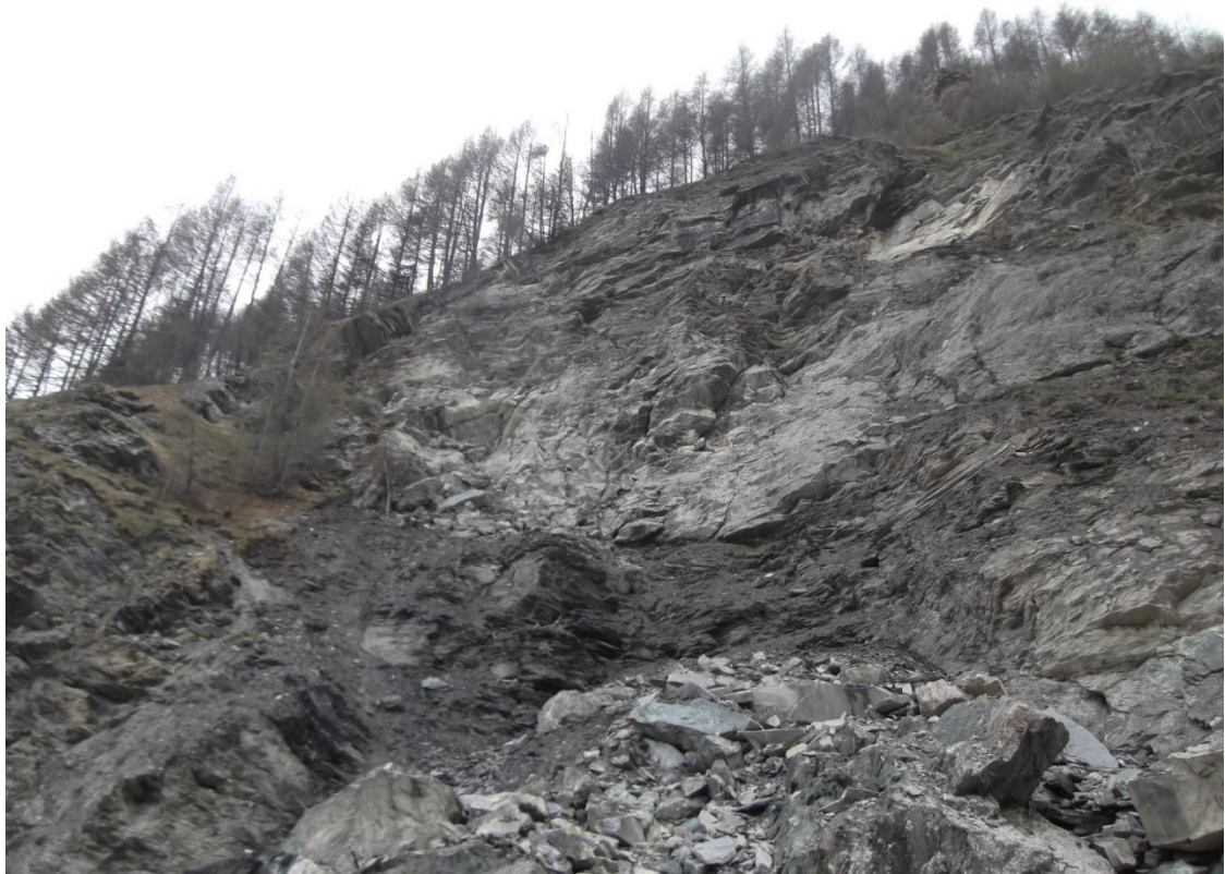
Porzione del versante oggetto di crollo
