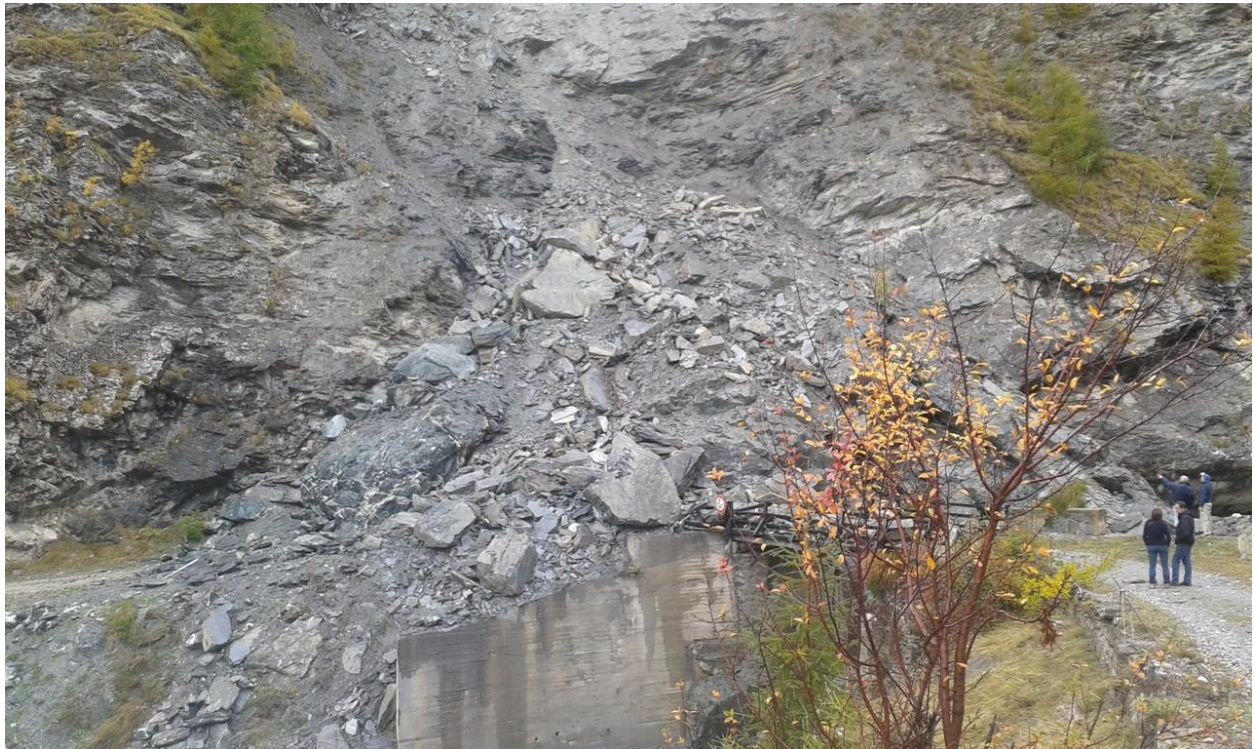
Materiale accumulatosi sul sedime stradale (vista dal versante opposto in sinistra orografica)
