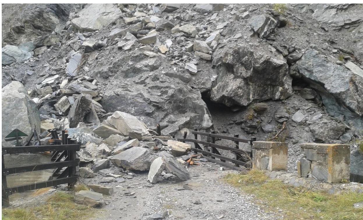
Materiale litoide accumulatosi sul ponte e parapetto danneggiato
