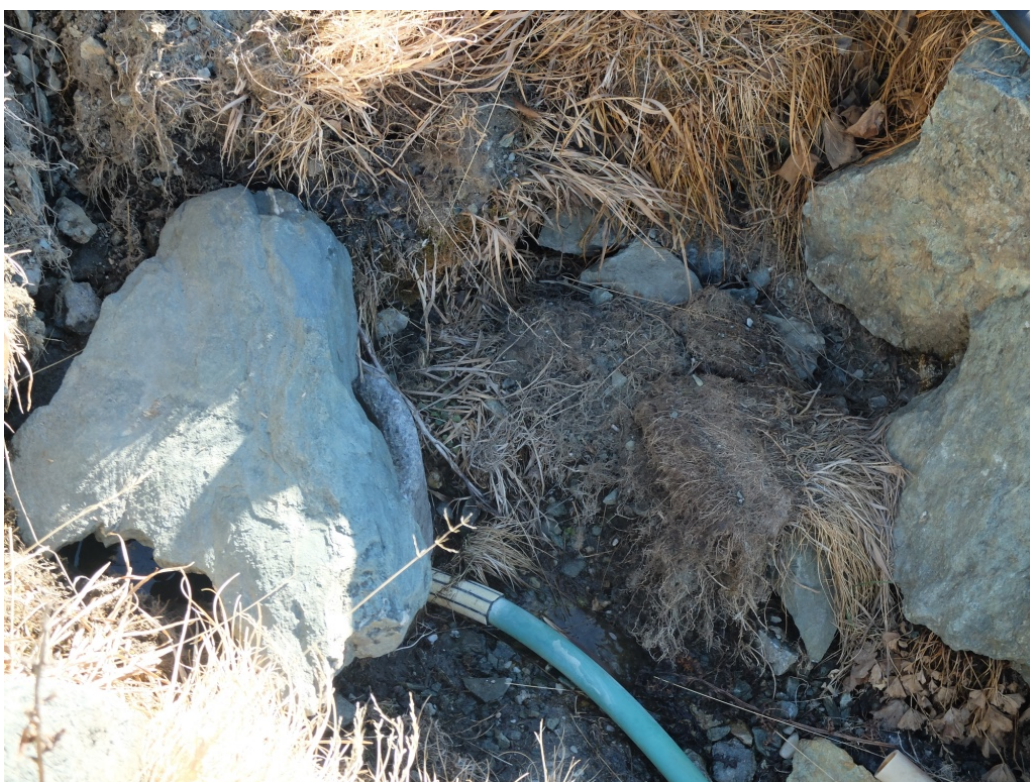
Foto n.10 – Pozzetto di presa con tubo che porta all'abbeveratoio.
