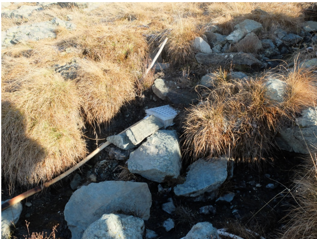
Foto n.13 – Pozzetto con griglia.
