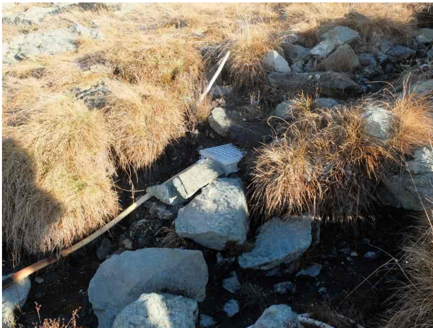
Piccola opera di presa con griglia e tubazione in gomma fuori terra che convoglia l'acqua all'abbeveratoio mobile.
