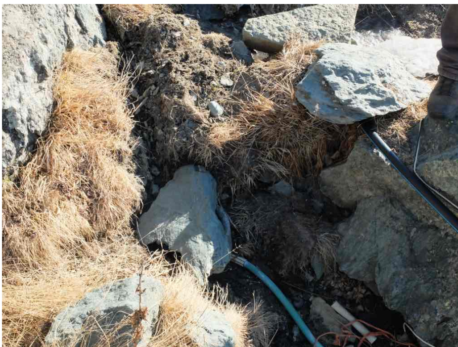
Pozzetto di captazione (sotto la pietra) con tubo in gomma.
