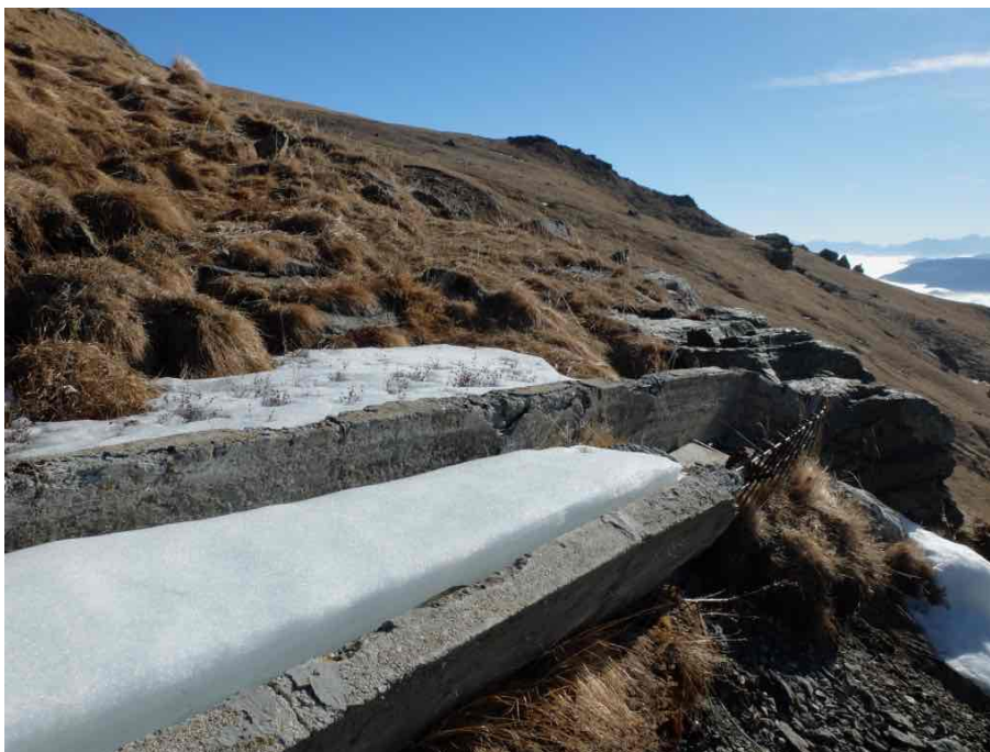
Abbeveratoio in calcestruzzo armato, ormai inutilizzabile.
